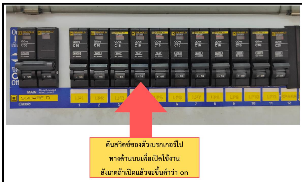
ภาพที่ 3.8 แผงเซอร์กิตเบรกเกอร์ภายในห้องควบคุม (จุดที่ 2)
