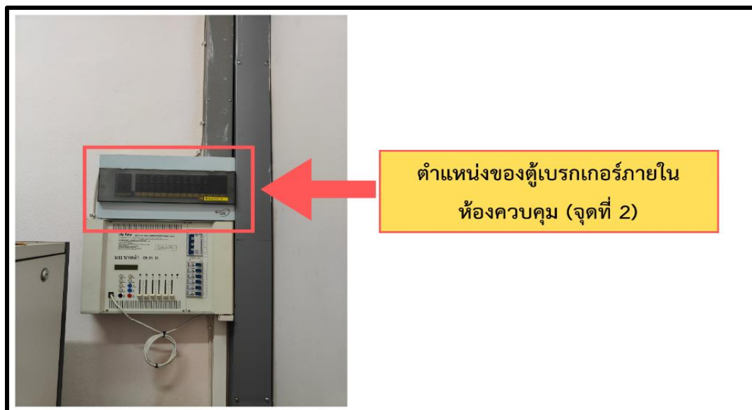
ภาพที่ 3.7 ตำแหน่งของตู้เบรกเกอร์ภายในห้องควบคุม (จุดที่ 2)
