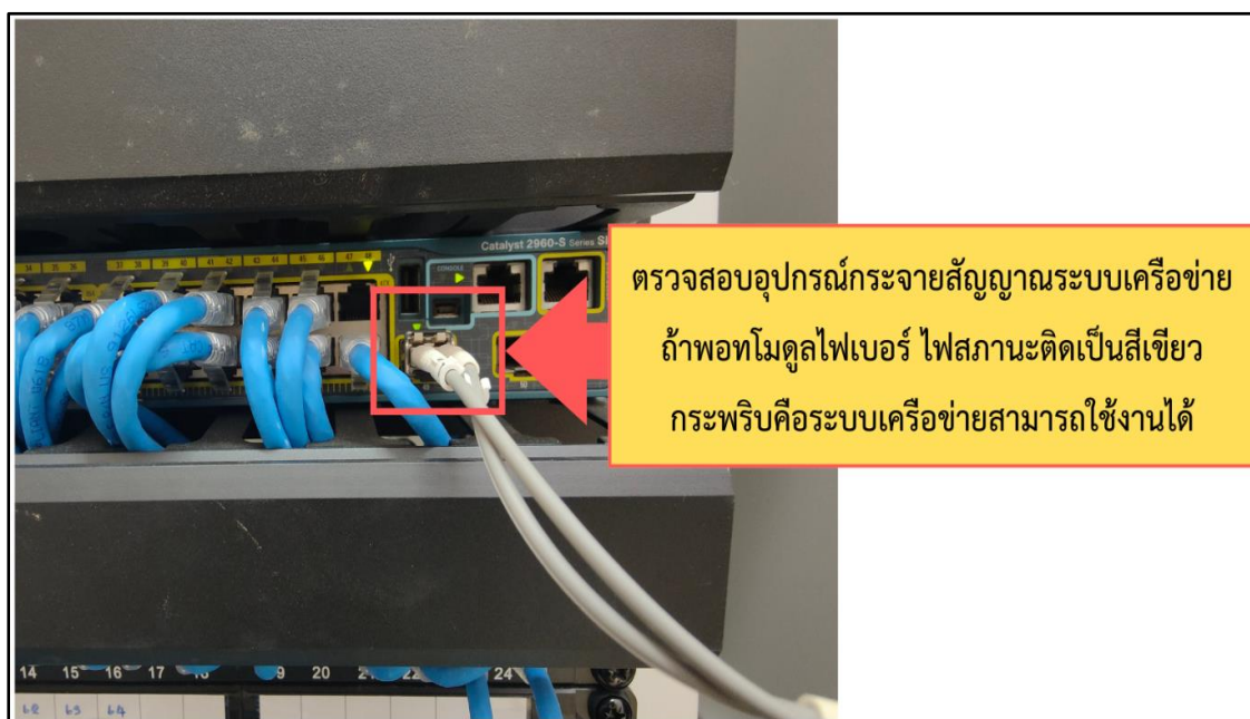
ภาพที่ 3.18 การตรวจสอบไฟสถานะบนอุปกรณ์กระจายสัญญาณระบบเครือข่ายพอร์ทโมดูลไฟเบอร์ออฟติก
