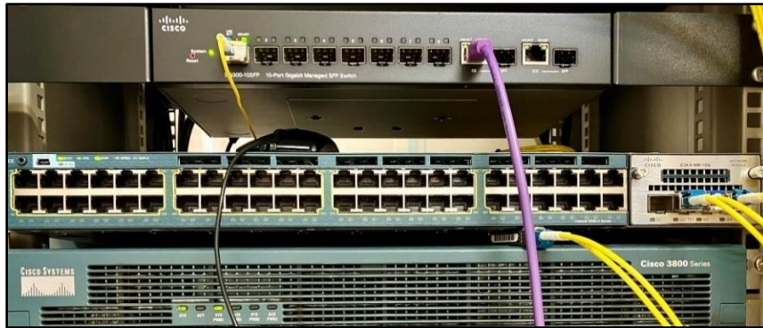
ภาพที่ 4 อุปกรณ์เชื่อมต่อสัญญาณ Network Switch
