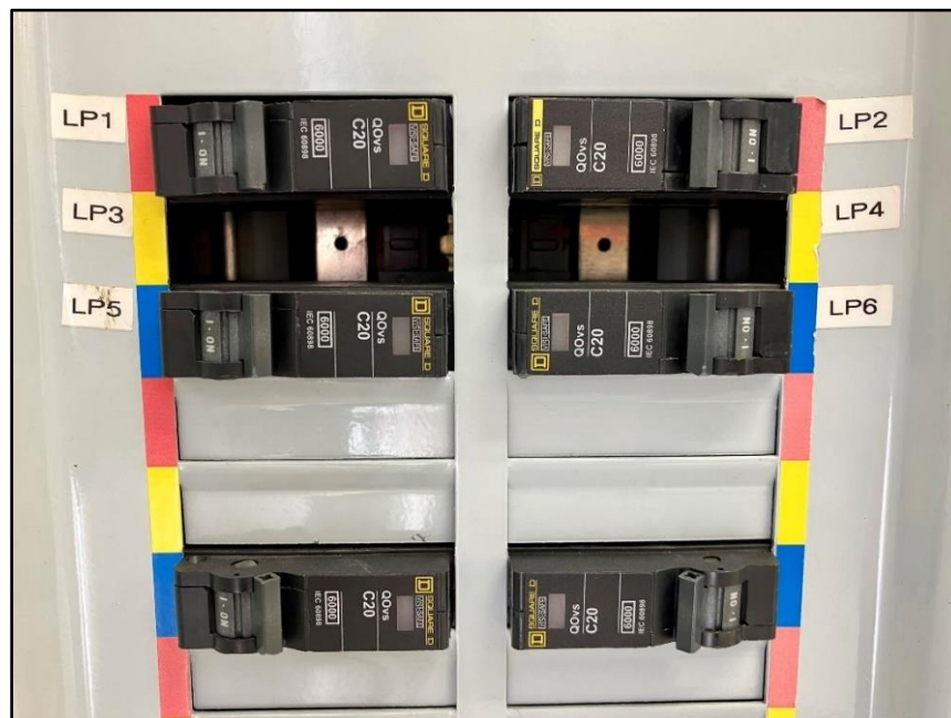
ภาพที่ 5 สวิตซ์ไฟฟ้าอัตโนมัติ Circuit Breaker
